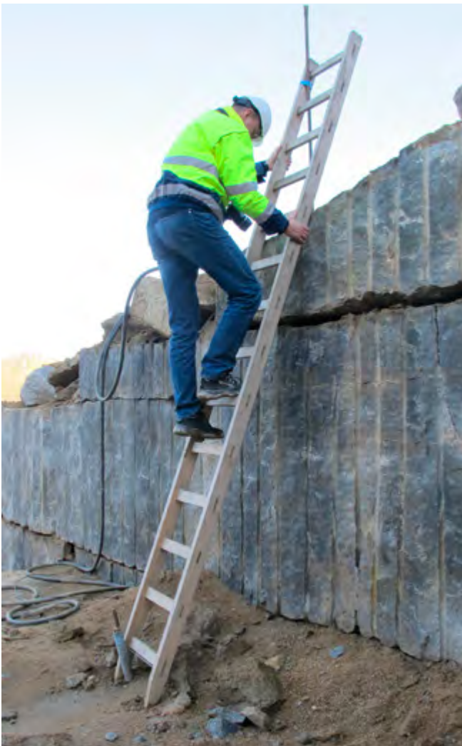
Abb. 1 Verkehrsweg Leiter, fixiert oben und unten
