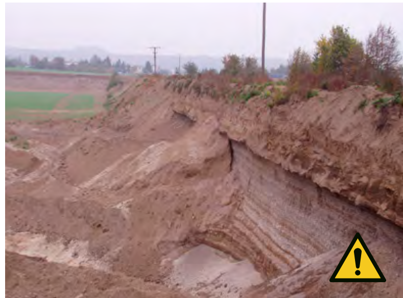
Abb. 2 So nicht! Fehlender Schutzstreifen nach der Abraumbeseitigung
