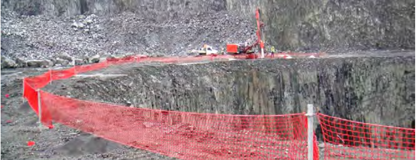
Abb. 2 Absturzsicherung im Arbeitsbereich einer Bruchwand
