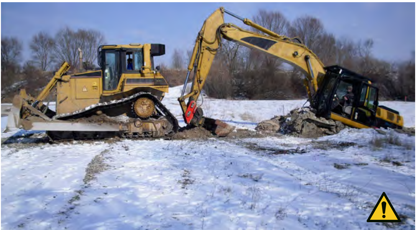
Abb. 2 Einsinken von Maschinen in nicht verfestigtem Material
