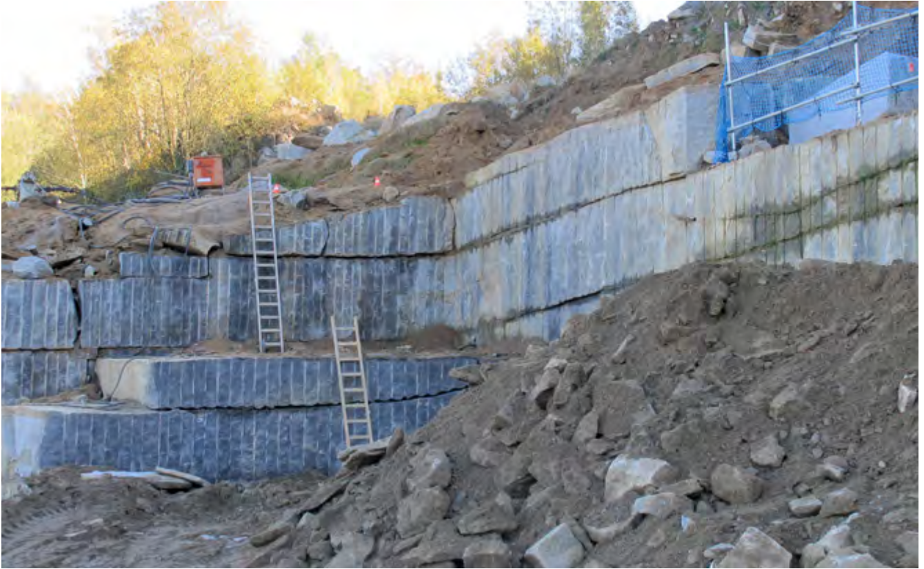
Abb. 1 Bruchwände und Verkehrswege
