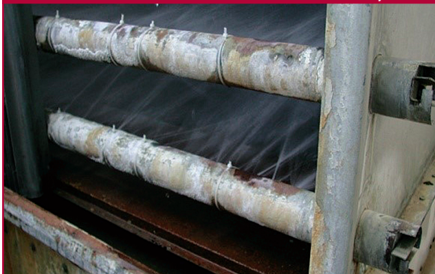
Figura 2 Aerosol prodotto all'interno di una torre evaporativa
