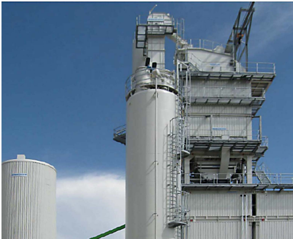
Bild 3: Außensilo mit verfahrenstechnischer Prozessanlage
