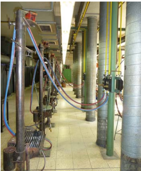
Bild 7 Schweißerei mit Schichtlüftung
