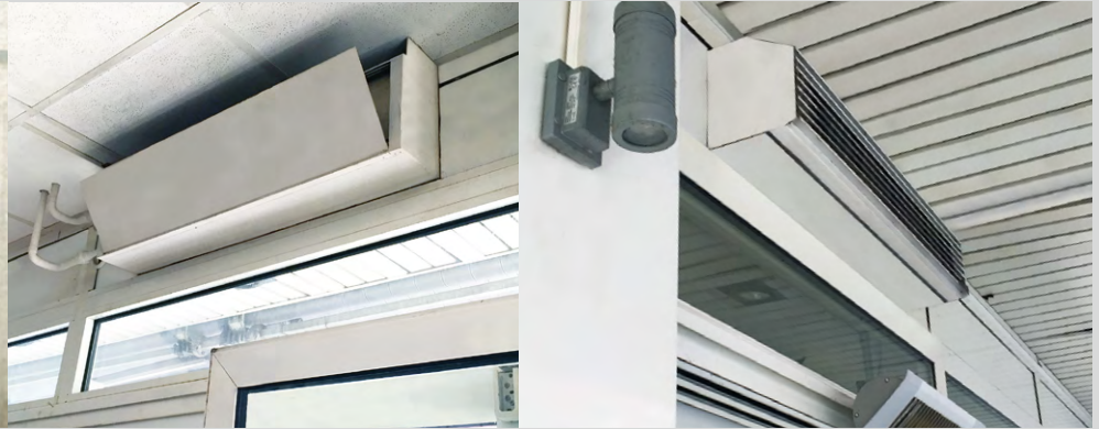
Beheizte Zuluftanlage (Innen- und Außenansicht)
