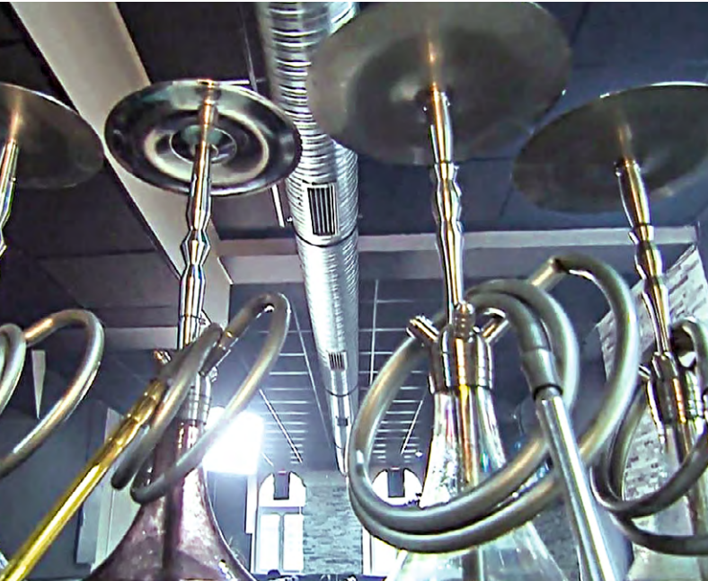
Gastraum mit Lüftungsanlage © SWR
